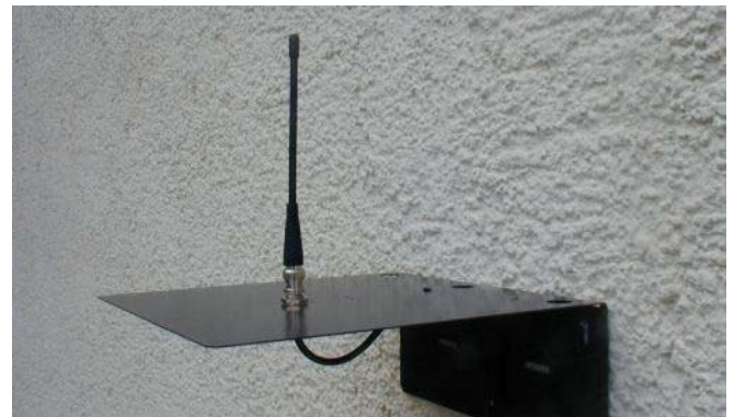
Antennenmontageplatte mit Stabantenne
